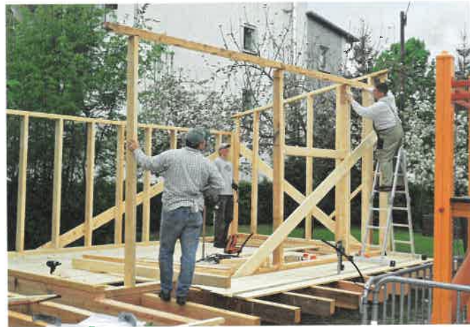
▲ Das Kreativhaus wurde als klassischer Holzrahmenbau geplant und auf zwei Stahlträgern mit je drei Einzelfundamenten aufgeständert
